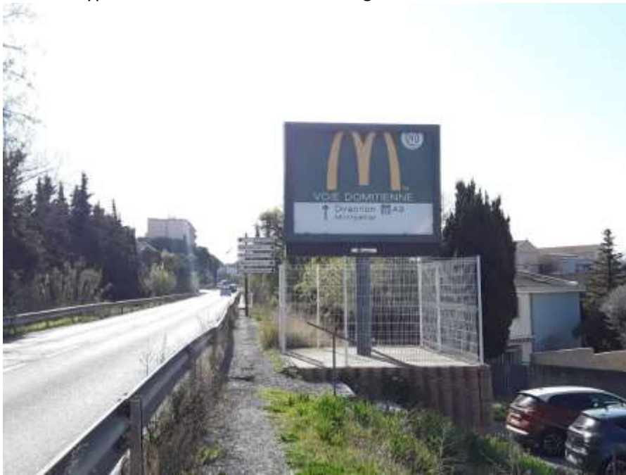
Le bloc de béton au pied du panneau qui alourdit l'ensemble n'est pas bienvenu.
