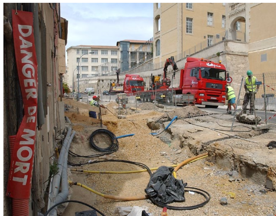
En 2006, un effondrement s'était produit boulevard d'Angleterre, nécessitant d'importants travaux.
